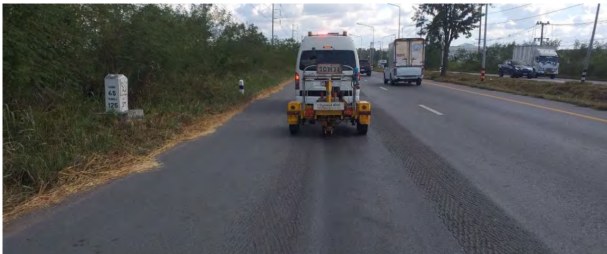
ภาพที่ ๔.๒ ร่องล้อที่เกิดขึ้นทางหลวงหมายเลข ๓๔๔ ด้านขวาทาง (ธันวาคม ๒๕๖๖)
